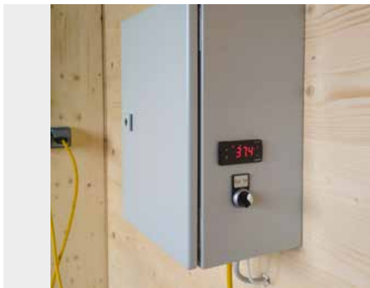
Schaltschrank mit Netzgerät & Temperaturrelais
